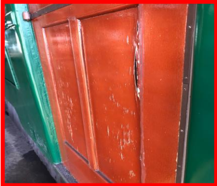
②木製扉の腐食
